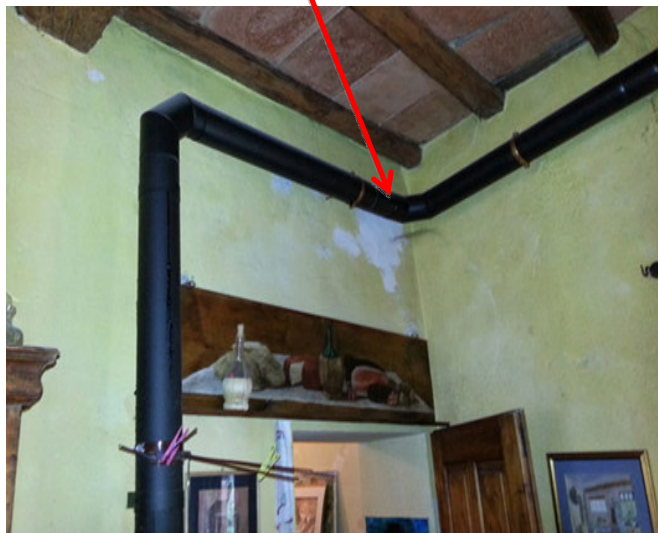
Elementi orizzontali e troppe curve
