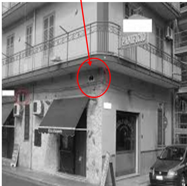
Assenza del terminale di scarico
